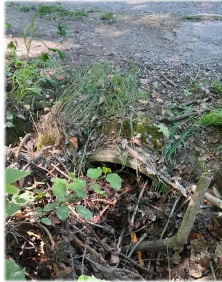
Fig. 8 – Ouvrage obstrué par des corps flottants (feuilles mortes, bois, etc...)
